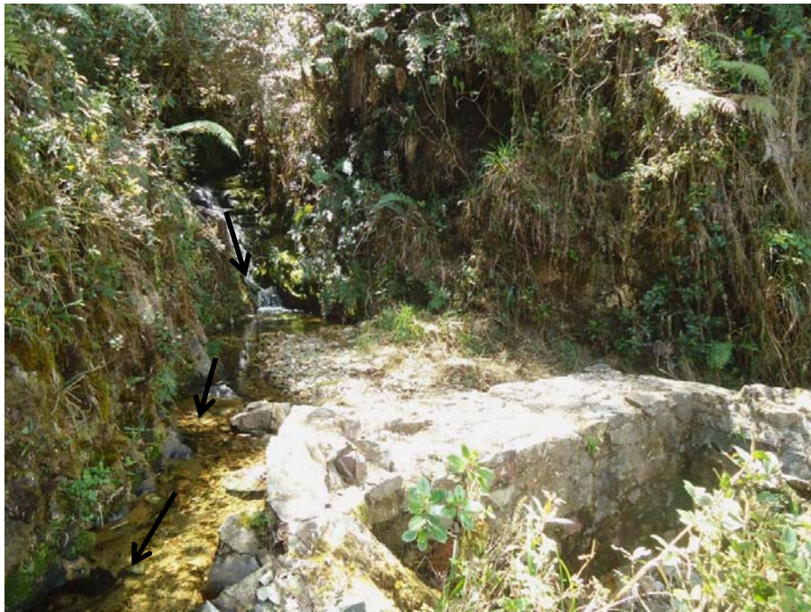
FOTO 4: Quebrada Granadillas en el inicio del canal Ocshawilca (Km 0+000). En este punto es necesario definir una dotación de agua para los agricultores de la parte alta de Querocoto. Se aprecia la toma colmatada y solo una parte del caudal viene siendo derivado hacia Llama.
