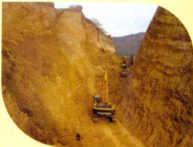
Foto N° 04. Zona con taludes altos, es un riesgo constante de derrumbes
