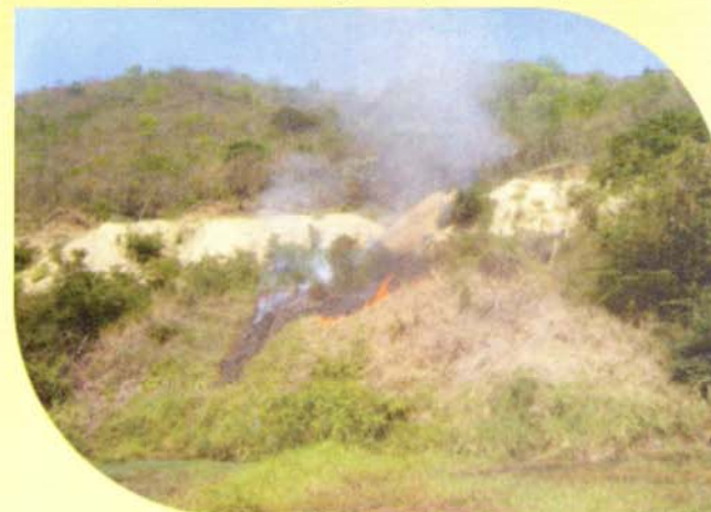
Foto N° 03. La quema de vegetación es una actividad que pone en riesgo la estabilidad del canal.
